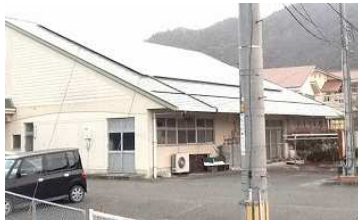
①備前クリーンが市民ファンドで設置した太陽光発電パネル
